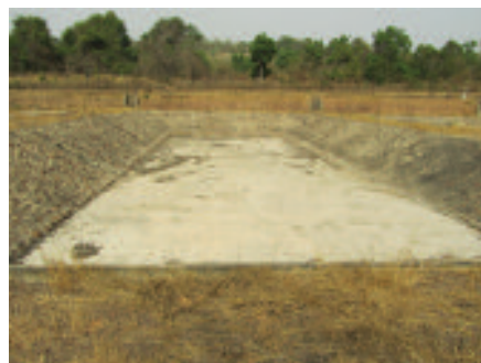
Figures 17 ab - Photographies de lagunages
